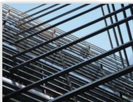
Unutrašnja platforma za pregled Internal platform for inspection
